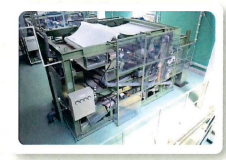
汚泥脱水機 メタン発酵槽の消化液を圧押し、水分を取り除きます。
