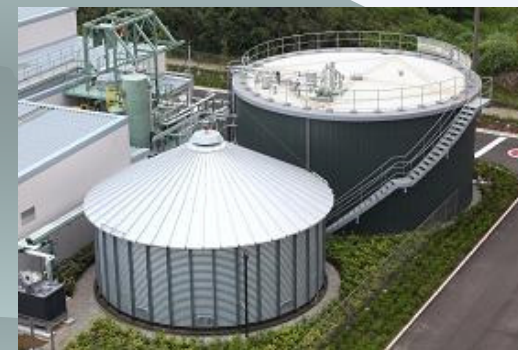
〈ガスホルダー(手前) とメタン発酵槽(奥)〉
